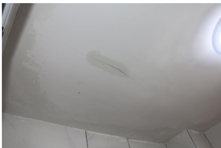
图 15 内抹灰层裂缝有渗水痕迹
