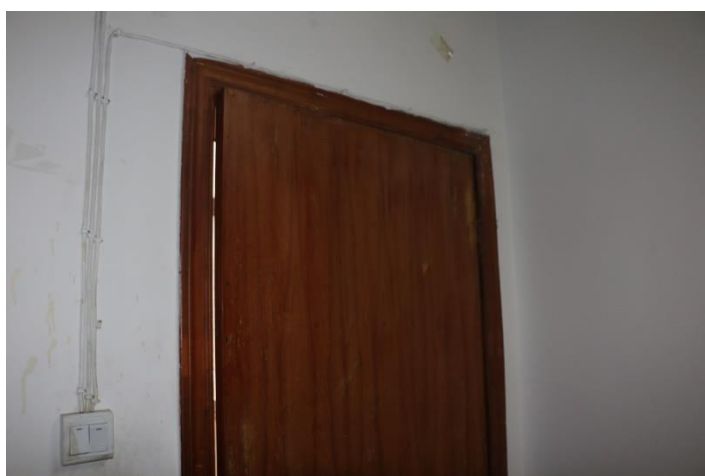
图 11 门窗部分翘裂，门窗框变形，开关不灵
