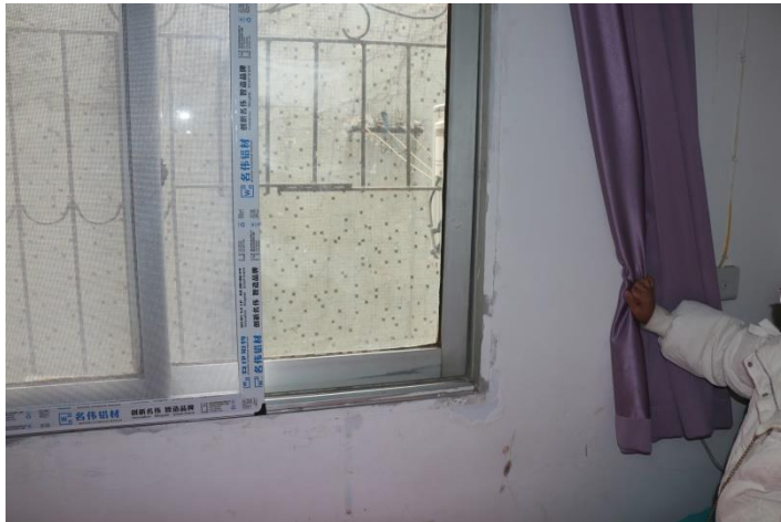
图 13 门窗部分翘裂，门窗框变形，开关不灵
